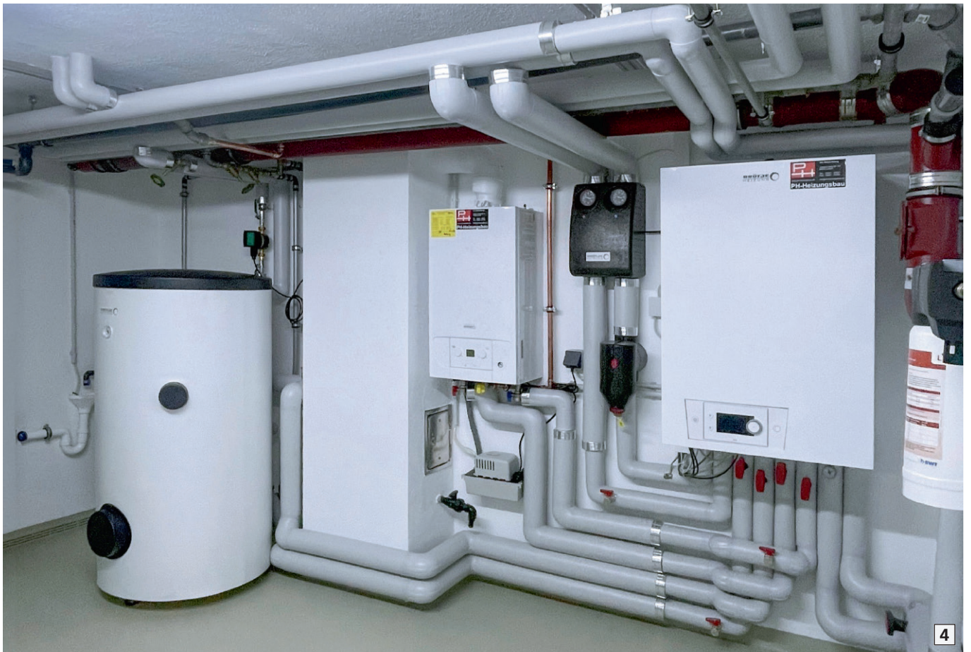
4 Die Hybrid-Systemtechnik (v.l.n.r.): 300-l-Trinkwasserspeicher „EAS“, Gas-Brennwerttherme „WLS 24“, Pumpengruppe, Inneneinheit der Luft/Wasser-Wärmepumpe „BLW Mono-P 11“ mit integriertem 40-l-Trennpuffer. (Foto: Jonas Pfaff, Pfeiffer & May, Karlsruhe)
