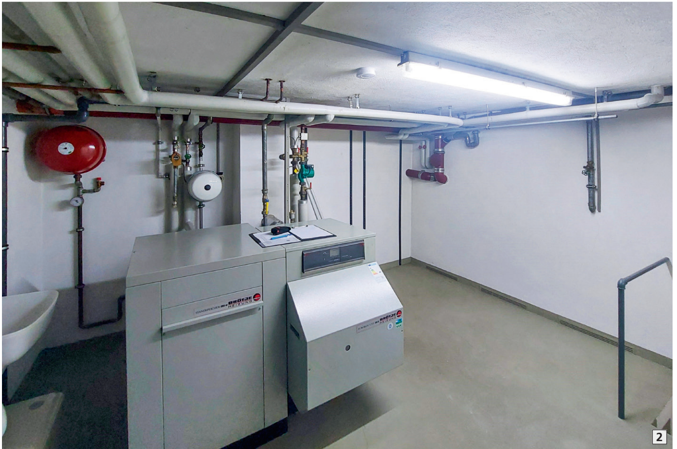
2 Vor der Heizungssanierung: der atmosphärische Brötje-Gaskessel von 1993. (Foto: privat)
